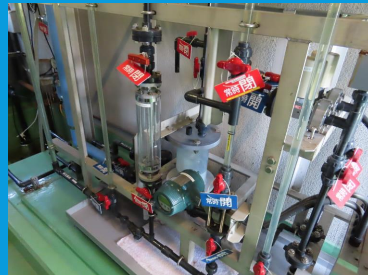
消毒設備（薬品注入）
