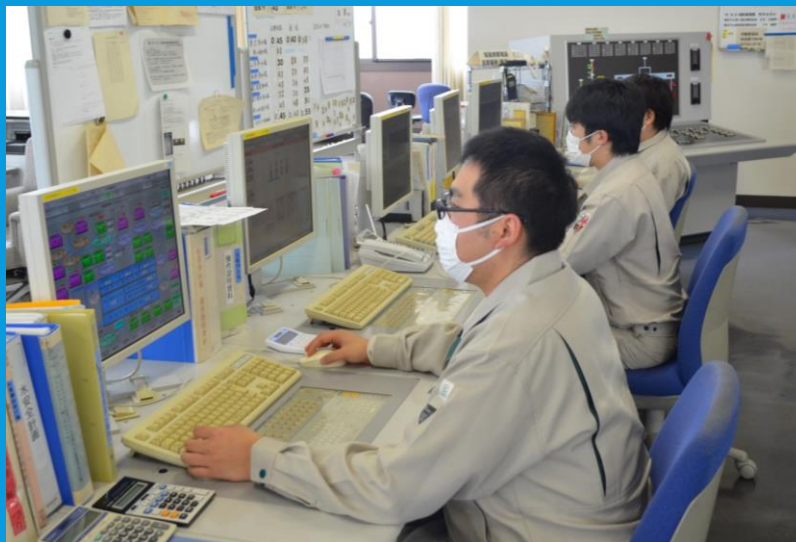
中央監視室（見崎浄水場）
