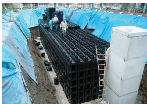
雨水貯留浸透施設整備状況
