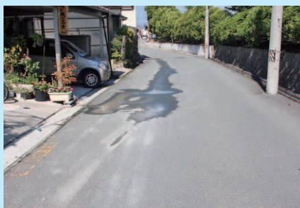
漏水により地上にしみ出る水道水
