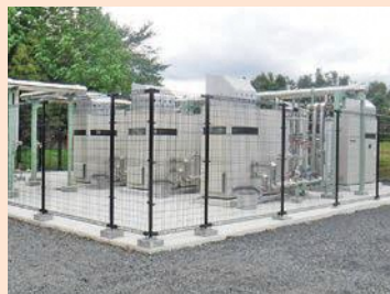
更新された発電設備(浄化センター敷地内)
