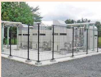
更新された発電設備(浄化センター敷地内)
