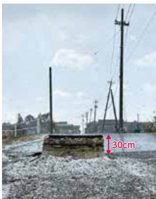
能登半島地震により浮上したマンホール(石川県珠洲市)
