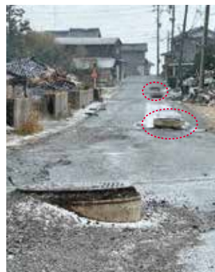
下水道機能がマヒするほか、道路の地割れや、障害物となり、緊急車両の通行や復旧作業の妨げになります。
