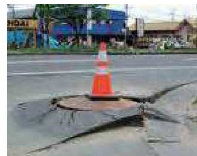
東日本大震災の揺れにより浮上したマンホール(宮城県多賀城市)
