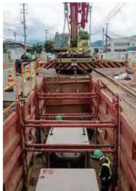
整備中 道路下に大断面（900mm）～2500mmの雨水管（ボックスカルバート）などを埋設し排水機能を強化
