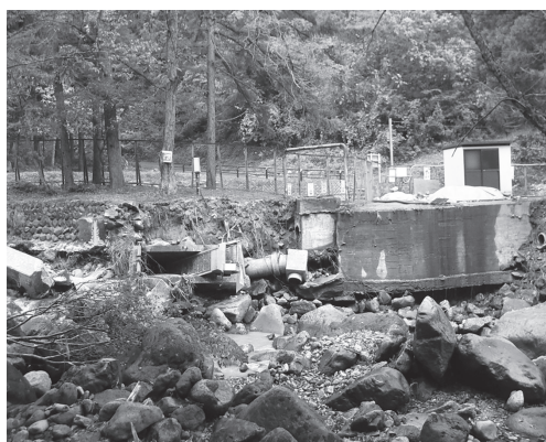
不動沢取水場護岸流出
