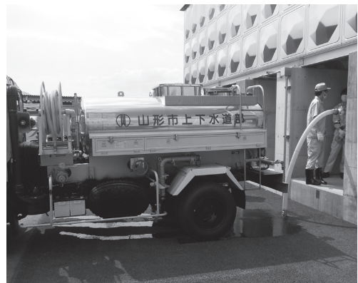
ポンプ施設と給水車の連携確認
