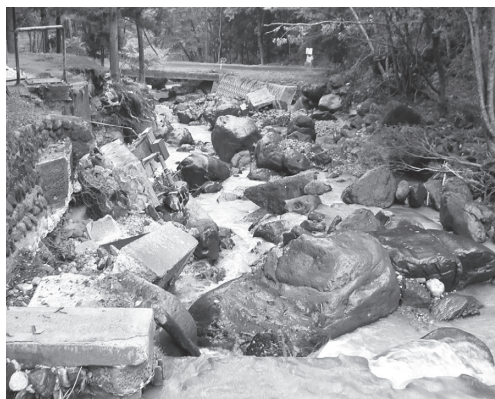
台風9号による不動沢取水場被害状況
