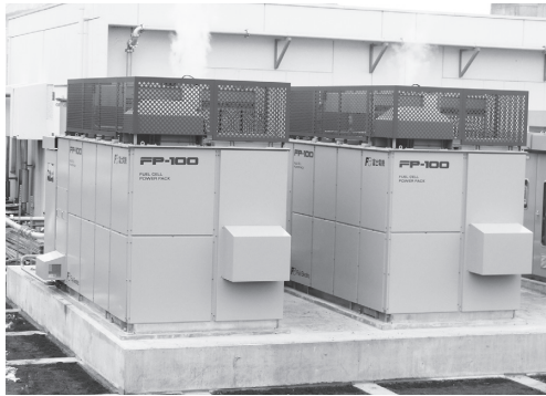
燃料電池式発電機
