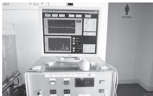
水質監視装置
