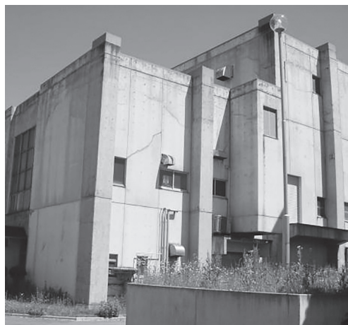
見崎浄水場排水処理施設
