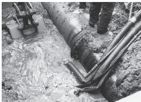
老朽管の破損漏水現場
