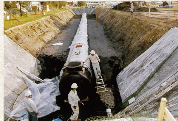
震災用緊急貯水槽整備工事 上下水道施設管理センター敷地内 (平成21年)
