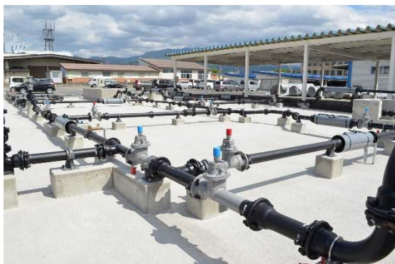
<地上配管エリア>
